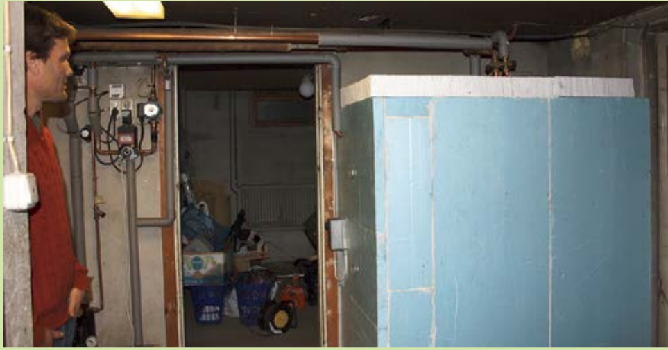
Akkumulatortanken med extra isolering. I bakgrunden syns också rör som fått ny isolering och shunten.
